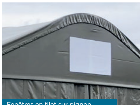
Fenêtres en filet sur pignon Anti-condensation net on the gable
